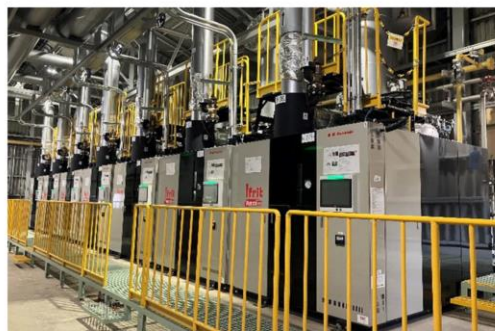
LNGボイラ設備(ニッケル工場)
